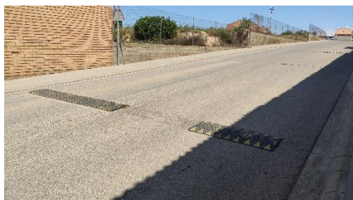
Imatge 41. Banda reductora en mal estat al carrer Rafael Casanovas
