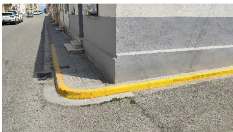
Imatge 13. Pintura groga reforçada a la travessia Sant Miquel
