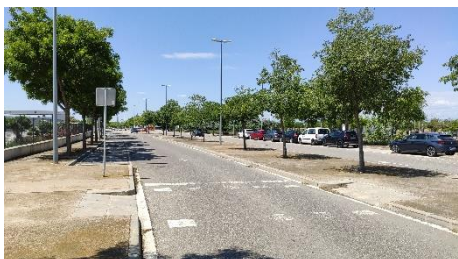
Imatge 9. Senyalització horitzontal de pas de vianants deteriorada al carrer principal del polígon Vinyes del Mig
