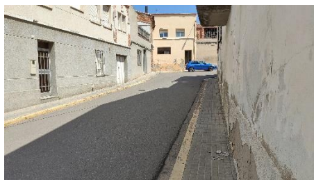
Imatge 10. Senyalització horitzontal groga de regulació de l'estacionament lleugerament degradada
