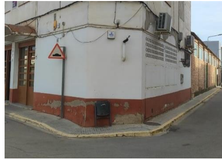
Imatge 66. Vista de l'edifici de la Societat Cultural Recreativa i la cruïlla amb el carrer Joan Oró
