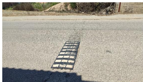
Imatge 42. Banda reductora en mal estat al carrer Rafael Casanovas
