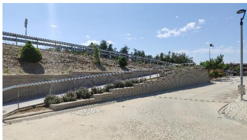
Imatge 49. Nou pas de vianants habilitat a la carretera LV-3311 amb rampes que permet creuar la via
